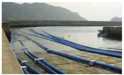
海洋深層水取水管（海底配管）
