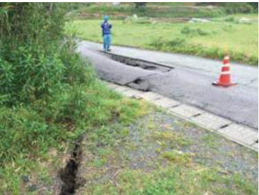
舗装面の損傷状況(砥川地区)
