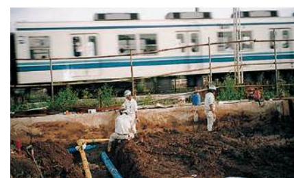
鉄道付近の配管（電食対策）
