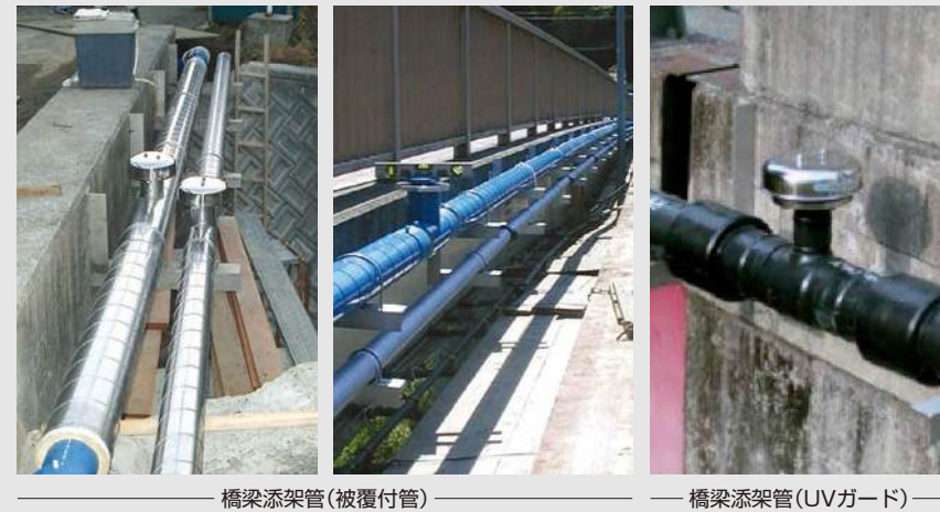
橋梁添架管(被覆付管)
