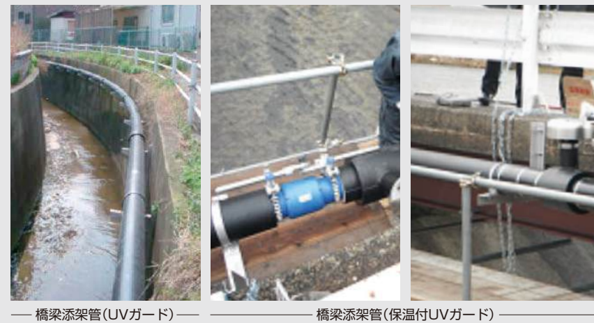
橋梁添架管(UVガード)
