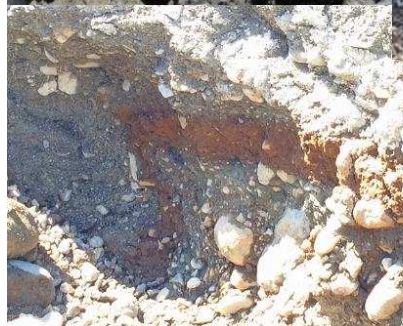
下水道管の被害
