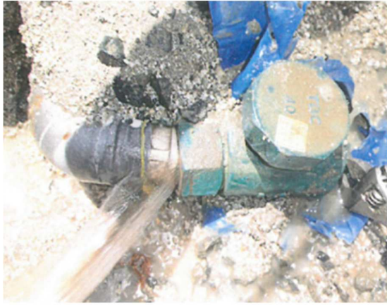
給水分岐と給水管接合部からの漏水
