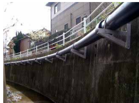
配管は、支持間隔2.5mでしっかり固定しました。 通水後も、大きなたわみも発生せず、生曲げ部にも 変形等は、ありません。
