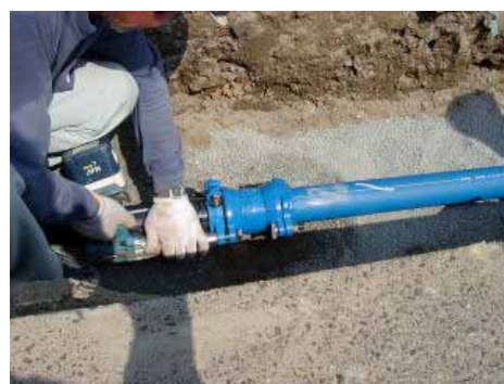
ボルトを締め付けて施工完了です。暑い中、お疲れ様でした。
