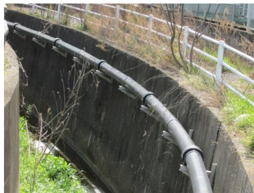
曲げ配管部（12年経過後）
