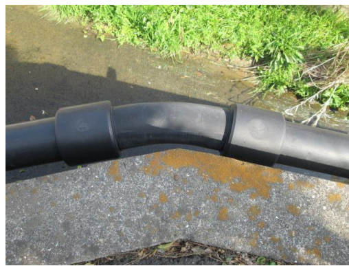
曲管及び接合部（12年経過後）
