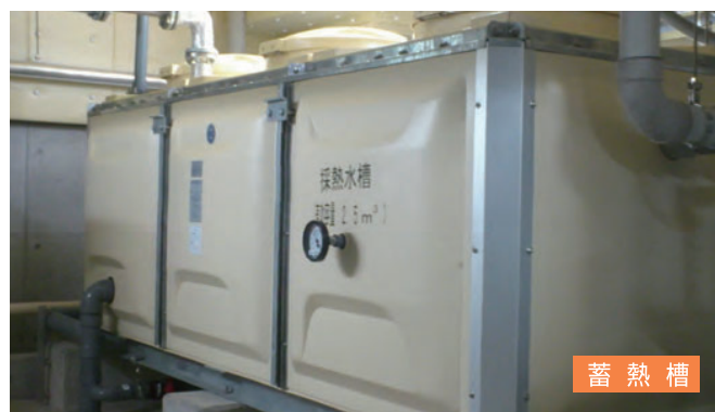
貯湯槽・温泉槽
