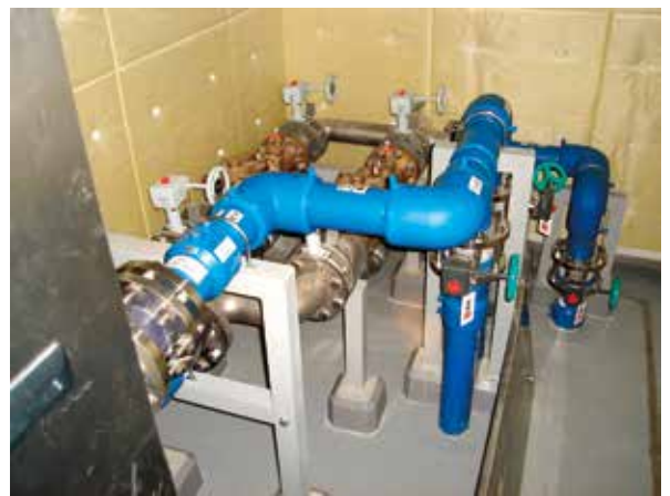
● 増圧ポンプ廻り
