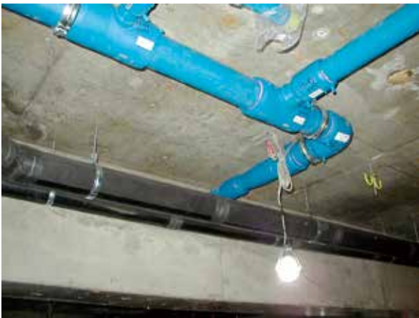
● 1階天井部チーズ分岐付近
