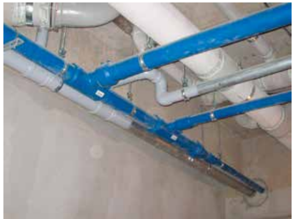
● 1階天井部チーズ分岐付近
