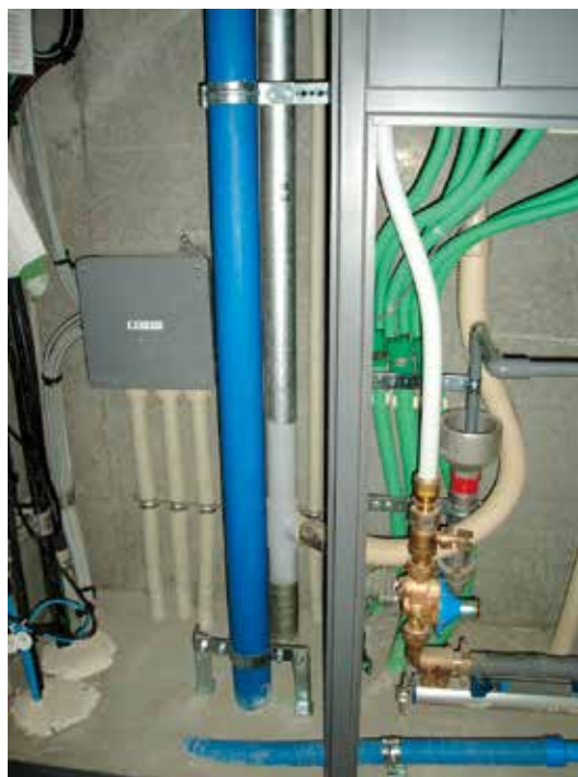
●立て管、支持固定の状況
