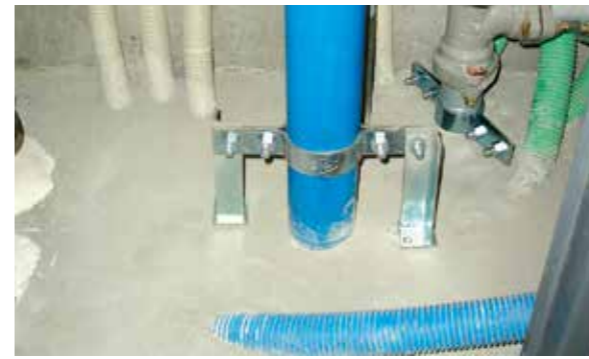
●床バンドと足を用いた支持固定
