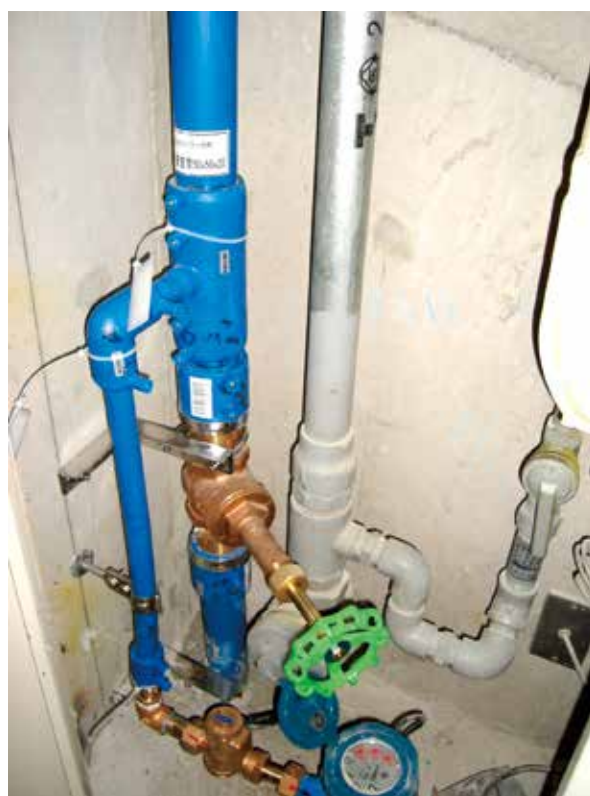
●ゲートバルブ付近
