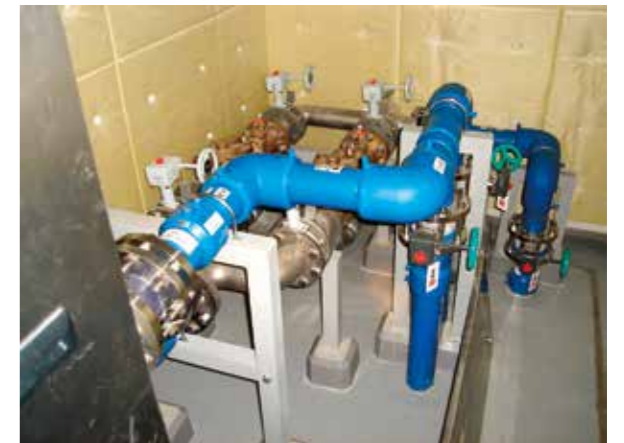
●増圧ポンプ廻り
