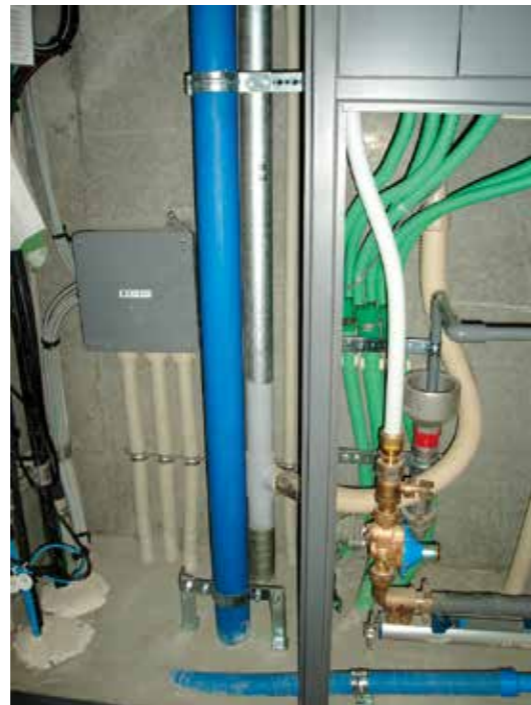
●立て管、支持固定の状況
