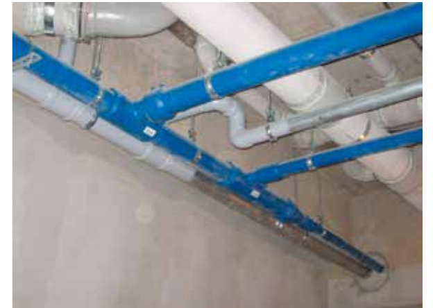
●1階天井部チーズ分岐付近
