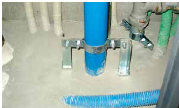
●床バンドと足を用いた支持固定
