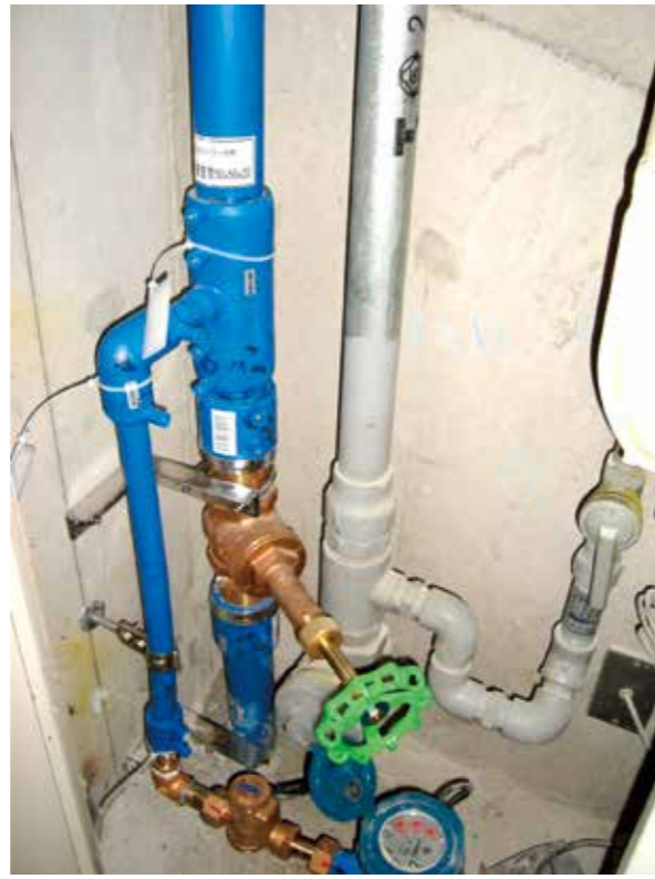
●ゲートバルブ付近
