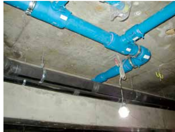
●1階天井部チーズ分岐付近
