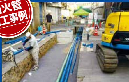
工場埋設消火配管
