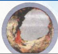
錆びた金属管の内部
