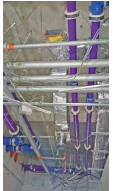
既設配管が入り組む場所でのクウチョウハイパーCH配管(保温前)
