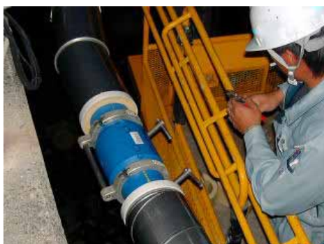
管の接合にはEFソケットを使用。融着により完全に一体化しますので、スラスト対策は必要ありません。融着後、カバー時に邪魔になる電極を切断します。
