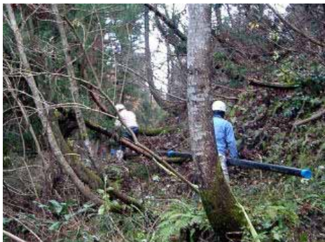
[ 事例 3 ] 破損管路の復旧 直線部分は、作業性の良い場所で、あらかじめ E F 接合して作成した長尺管を運び込んで施 工しました。7 5 A の場合 2 本つないでも約 3 0 k g と軽量です。
