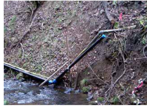
[ 事例 3 ] 破損管路の復旧 土砂崩れが発生した部分は、地盤が安定していな い為、斜面下に配管を布設していきます。
