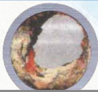
錆びた金属管の内部
