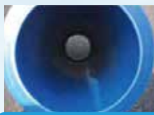
9年間使用したPE管の内面
