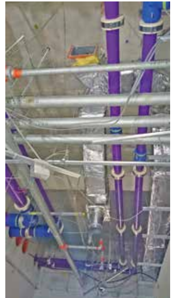
既設配管が入り組む場所でのクウチョウハイパーCH配管(保温前)
