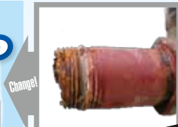
老朽化した金属管
