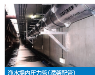
浄水場内圧力管(添架配管)
