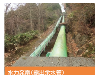
水力発電(露出余水管)
