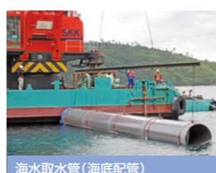
海水取水管(海底配管)
