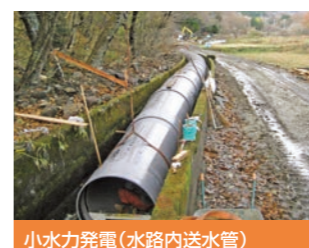
小水力発電(水路内送水管)
