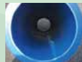
9年間使用した PE管の内面
