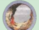
錆びた金属管の内面
