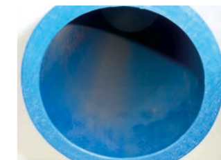
19年間使用した管の内面
