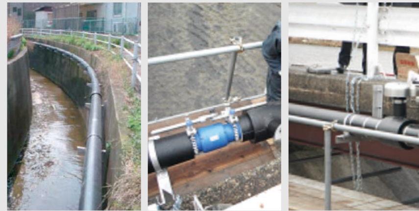
橋梁添架管(UVガード)
