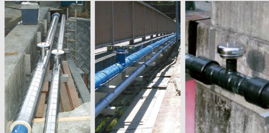
橋梁添架管(被覆付管)
