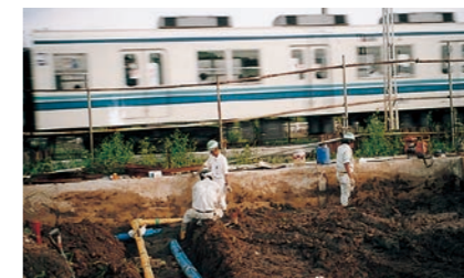
鉄道付近の配管(電食対策)
