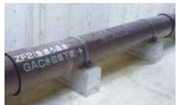
大阪府浄水場内配管(FRPMφ500)
