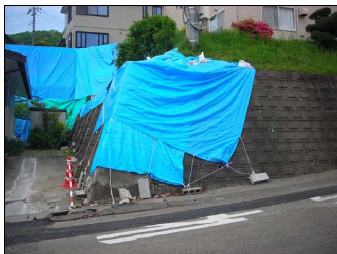
地震で被災した擁壁は、各地に散見されます
