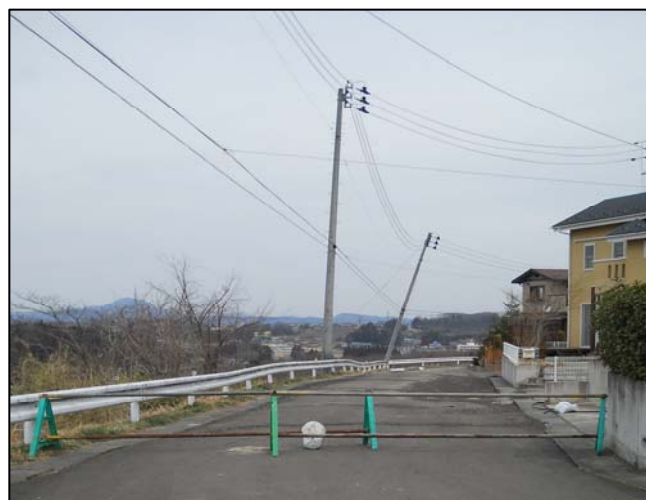
付近は道路が崩落し、一部通行止め
