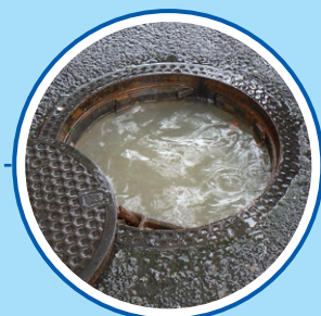
マンホールからの溢水
