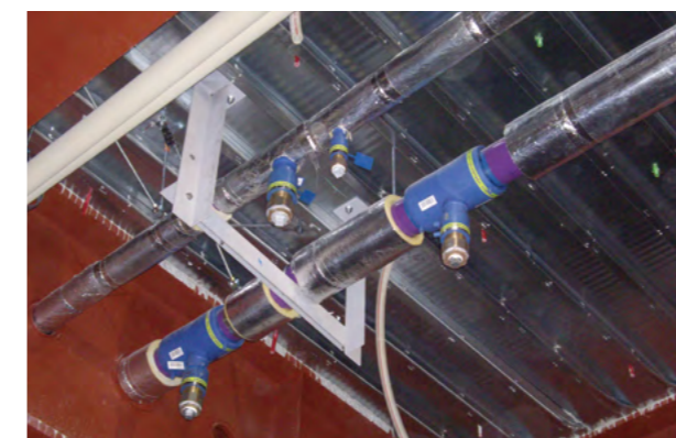
天井内配管 (ネジで分岐)
