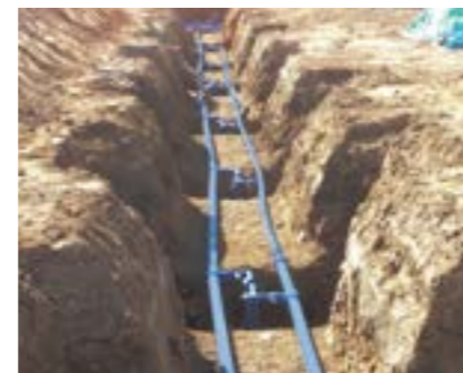
横引き管と分岐部
