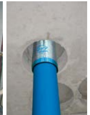
防火区画貫通部
