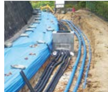
神社参詣道屋外消火栓の埋設配管
