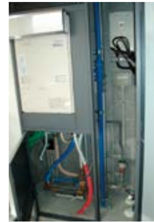
パイプシャフト内
