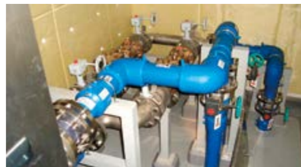
増圧ポンプ廻り
