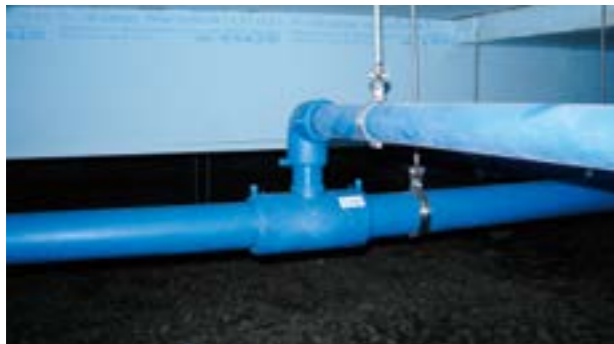
チーズ分岐付近(熱伸縮でたわみが発生する場合があります。)
