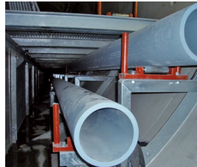
処理場連絡管路 (汚泥管路)
