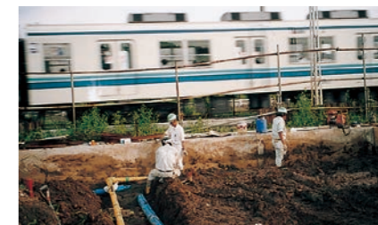
鉄道付近の配管(電食対策)
