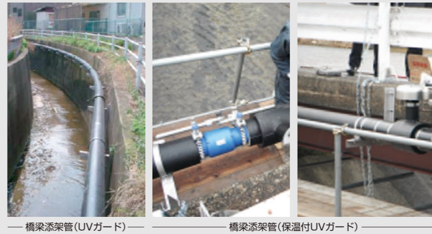
橋梁添架管(UVガード)
