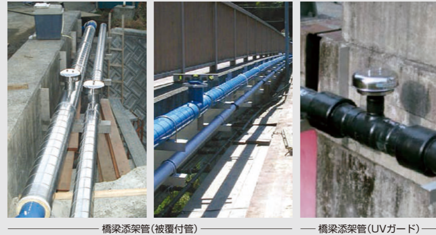
橋梁添架管(被覆付管)
