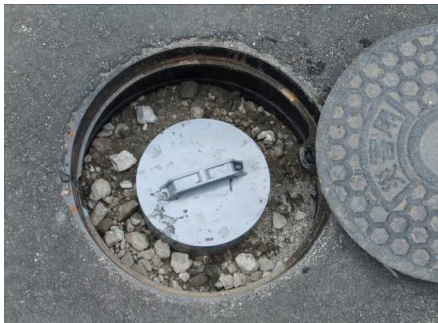
16. 注水口の塩ビ製内蓋を閉じる
