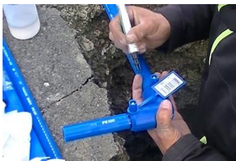
青ポリの給水管採用事例（静岡県）
