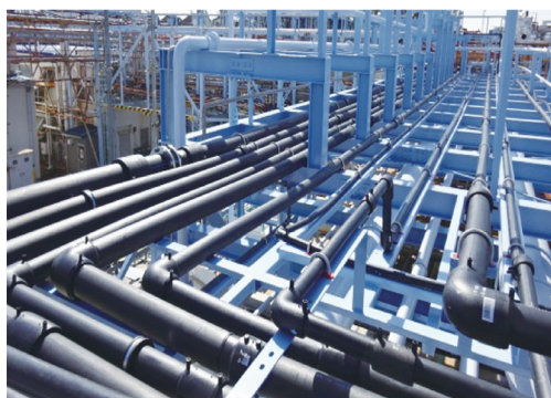
写真5 ラック上に敷設されたプラントハイパーBK
