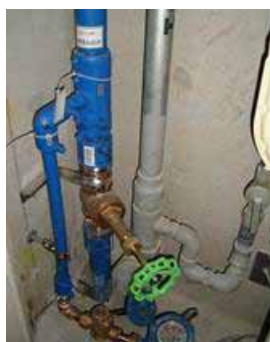
写真10 パイプシャフト 内配管例1
