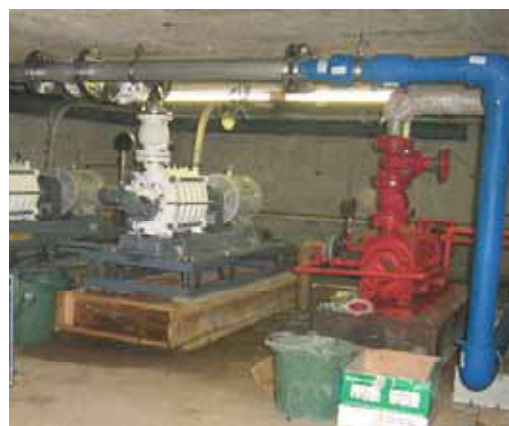
写真8 ポンプ周り配管例
