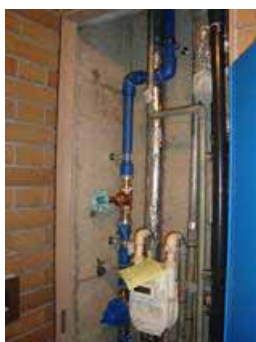
写真11 パイプシャフト 内配管例2
