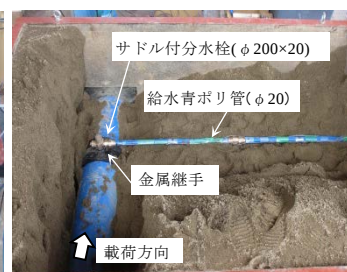
写真-3 配管状況
